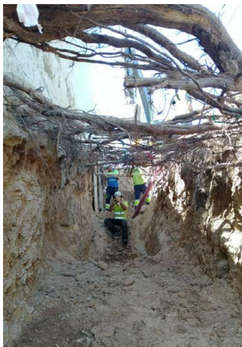
Conservación de raíces de un árbol singular con Airspade® para introducir una línea de alta tensión subterránea
